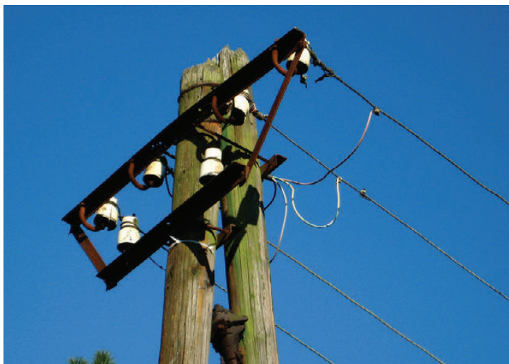
In hierdie foto is die houtpale en wit keramiekkappies elektriese isolators.
